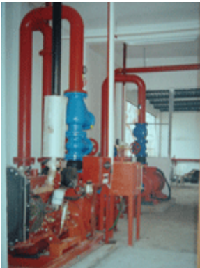
Cụm Bơm Chữa Cháy Sprinkler tại Chợ Đức Trọng- Lâm Đồng do CTy An Bảo lắp đặt
